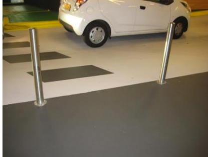
Ook het aanbrengen van afscheidingspaaltjes is geen enkel probleem voor de systemen van Triflex.
