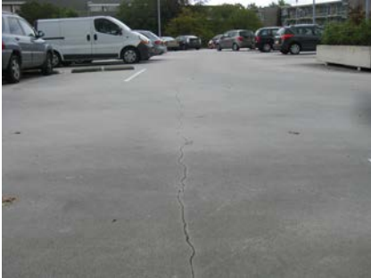
Het parkeerdek vertoonde veel scheurvorming waardoor lekkageproblemen zijn ontstaan.
