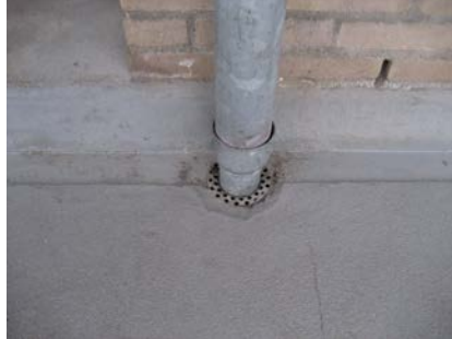
De goot en hemelwaterafvoer voor de renovatie
