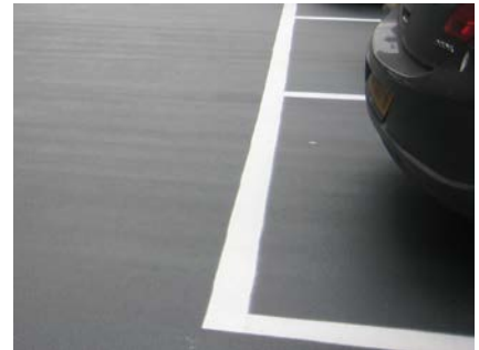
Na het aanbrengen van de laatste finishlaag wordt de belijning aangebracht en is het parkeerdek klaar voor gebruik
