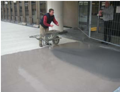
en deze wordt vervolgens ingestrooid om het vloerveld voldoende antislip te krijgen.
