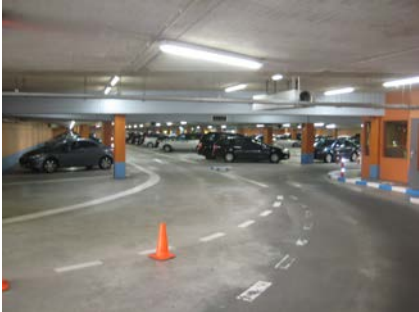
De parkeergarage Boscotonde was onderhevig aan vervuiling en slijtage.
