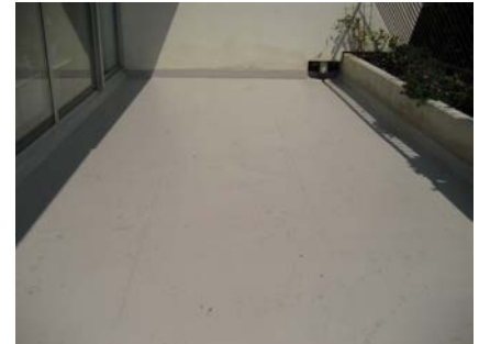
Het gehele vloerveld voorzien van het Triflex ProTect systeem om een waterdicht balkon te garanderen. De tegels kunnen nu eenvoudig worden teruggeplaatst over het Triflex systeem.
