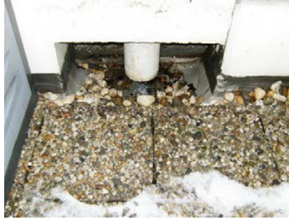
Hemelwaterafvoer die ook voor lekkage zorgde.
