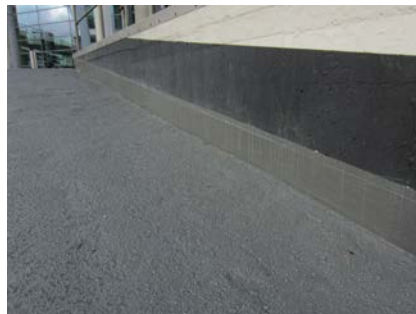
Schade aan de hellingbaan behoort tot het verleden door het duurzame en waterdichte Triflex systeem.
