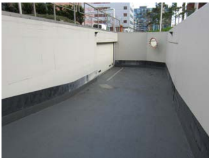
Door de hellingbaan te voorzien van een Triflex systeem voldoet deze weer aan alle eisen.
