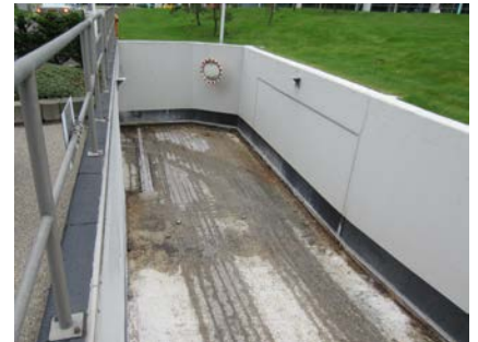
Om slippartijen te voorkomen is hellingbaanverwarming aangebracht.
