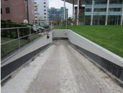
De onverwarmde hellingbaan voldoet niet aan de eisen.
