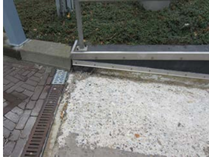
Ook bij de lijngoot en randaansluitingen is er de nodige schade aan de ondergrond.
