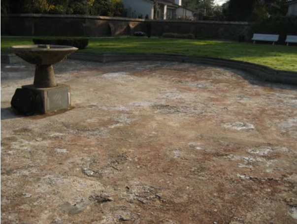
De vijver vertoonde veel scheuren in de constructie waardoor lekkageproblemen zijn ontstaan.
