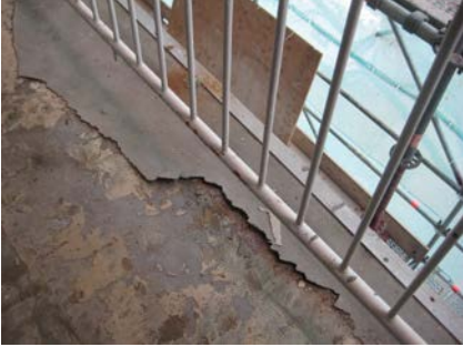
De aanwezige toplaag vertoonde veel onthechting.
