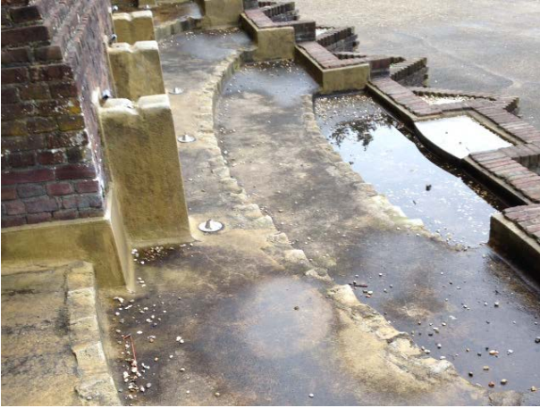
De bestaande epoxy coating was volledig vergaan.
