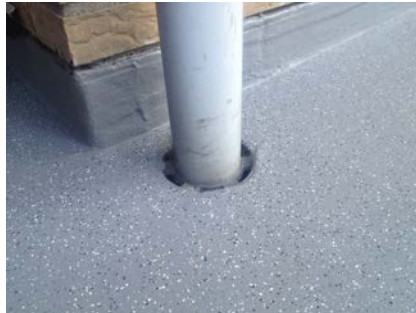
De hemelwaterafvoeren worden in het systeem geïntegreerd.
