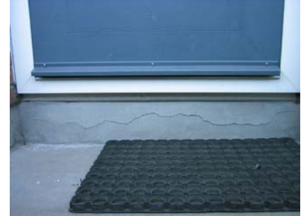
Zowel bij de opstanden als in het vloerveld is scheurvorming aanwezig.
