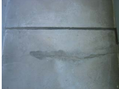
De afdichting van de dilataties is niet intact waardoor lekkageproblemen zijn ontstaan.
