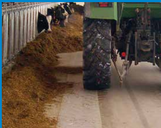
^ De overgangsvoegen tussen rijwegen en voergangen zijn extra beschermd
