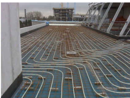
Geïntegreerd leidingwerk ten behoeve van warmte en koude winning
