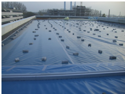
XPS Isolatie met PE glijfolie en afstandhouders ten behoeve van het wapeningsnet
